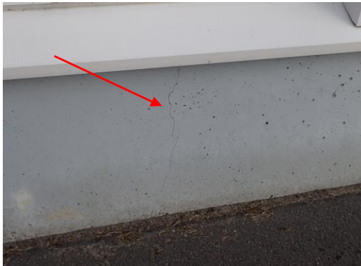
Kuva 17. Sokkelissa paikoin halkeilua
