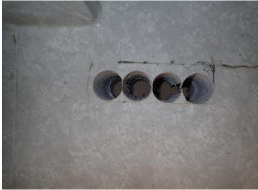
Kuva 42. IV-konehuoneessa paikkaamattomia läpivientireikiä lattiassa
