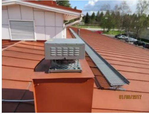
Kuva 24. PF-03 metallityötilan huippuimuri
