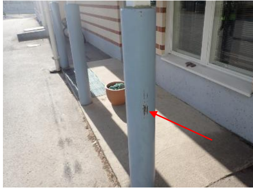
Kuva 26. Yksittäinen pinnoitevaurio katoksen pilarissa
