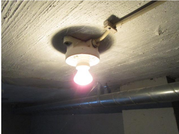
Kuva 49. Kellarin valaisimia (puuttui suojakupu).
