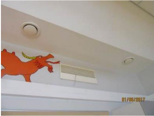
Kuva 27. Opetustilan tulo- ja poistoilmaventtiili
