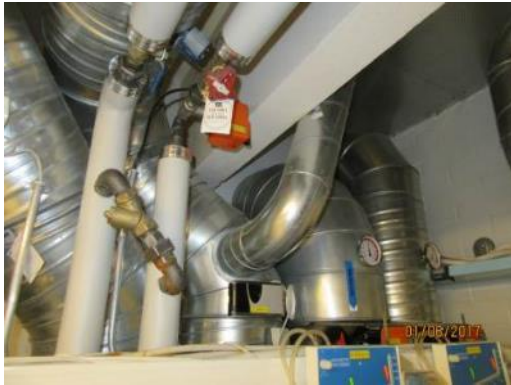
Kuva 25. Ilmanvaihtokanavat ovat hyvässä kunnossa
