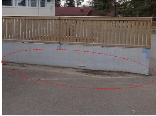
Kuva 4. Asfaltissa painauma muurin kohdalla
