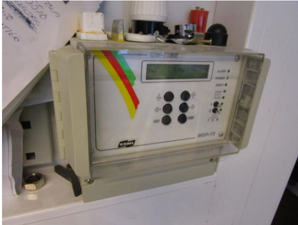
Kuva 59. Pääkello (kiinteistöhuollon tila).
