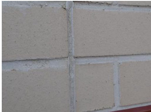
Kuva 18. Elastisessa saumassa halkeiluja
