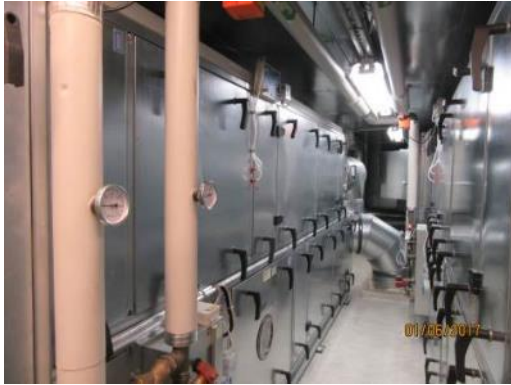
Kuva 17. Ilmanvaihtokoneet K1 ja K2
