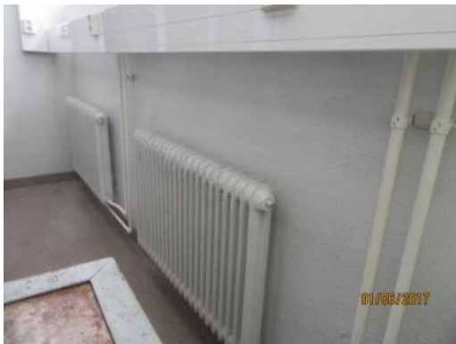
Kuva 1. Alkuperäiset patterit vuodelta 1960
