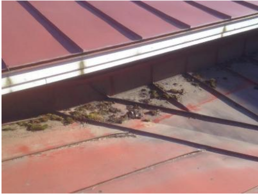
Kuva 34. Vesikatolla paikoin sammalkasvustoa
