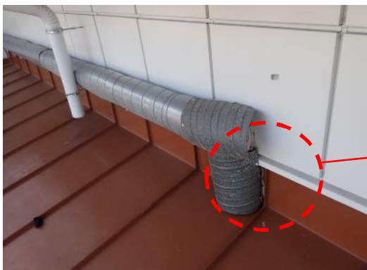
Kuva 32. Läpivienti IV-konehuoneen kohdalla
