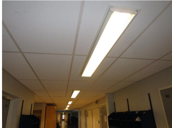
Kuva 50. Näkymä loistevalaisimista käytävällä.
