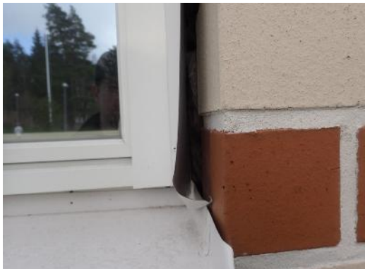
Kuva 21. Yksittäisessä ikkunassa pielipellin alareuna irti
