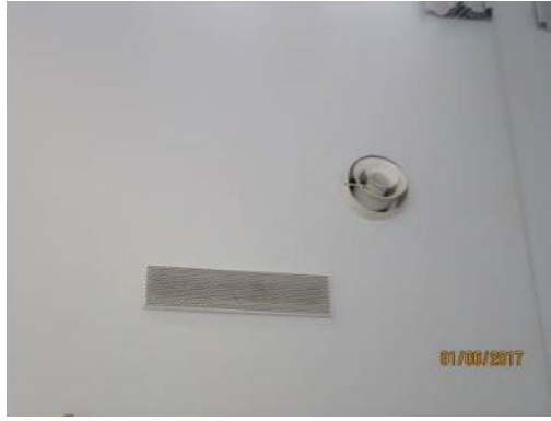
Kuva 28. Liikuntasalin tulo- ja poistoilmaventtiili
