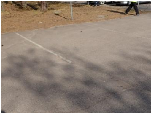
Kuva 11. Parkkiruutujen maalaukset ovat haalistuneet
