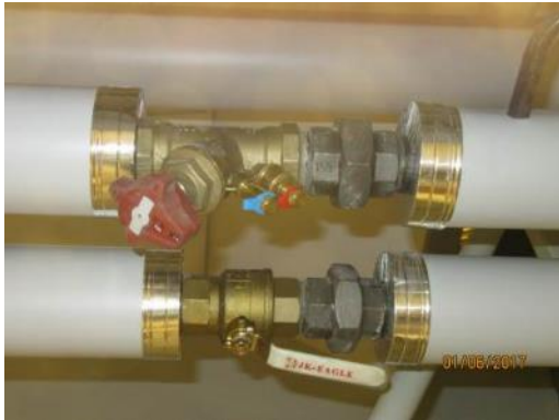
Kuva 61. Sulku- ja linjasäätöventtiili
