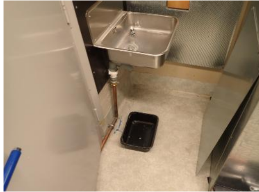
Kuva 43. Lattia kaataa kohti nurkkaa altaan kohdalla
