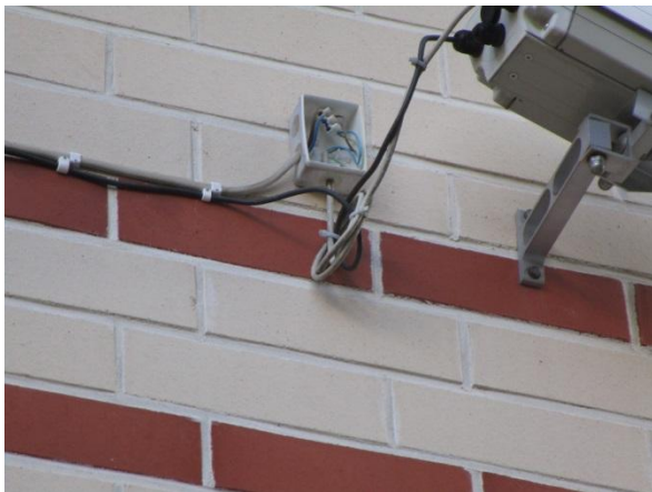
Kuva 47. Ulkoseinällä puuttui rasian kansi.
