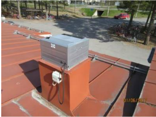
Kuva 23. PF-02 wc-tilojen huippuimuri
