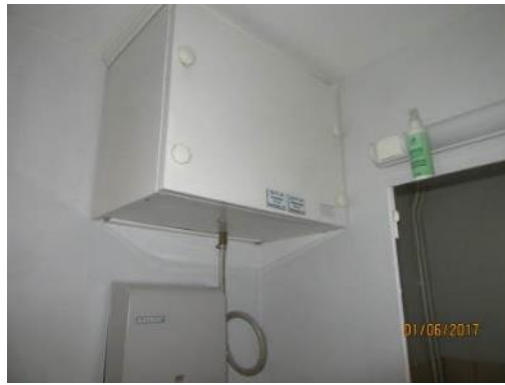
Kuva 22. Talonmiehen tilan Imanvaihtokone
