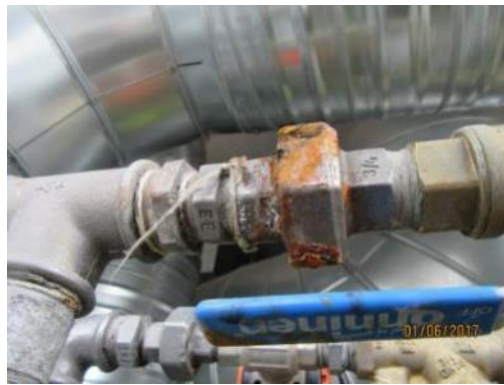
Kuva 2. Kartioliittimessä on vähäistä vesivuotoa
