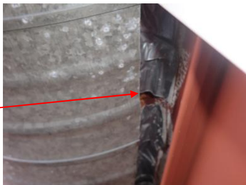
Kuva 33. Läpiviennin tiivistys puutteellinen
