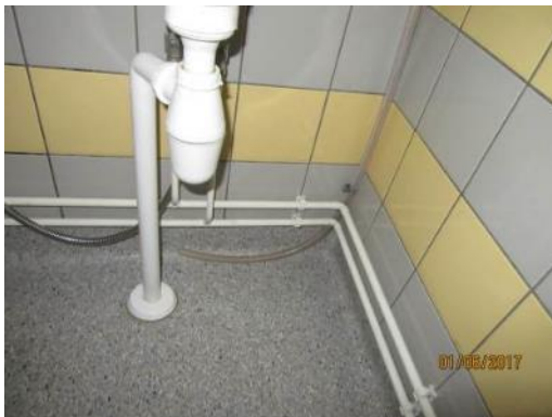
Kuva 7. Vesijohdot ovat kunnossa
