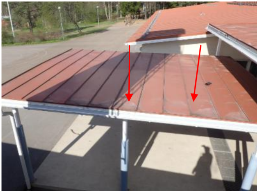
Kuva 27. Sisäpihan katoksen vesikatteessa viitteitä vesien lammikoitumisesta
