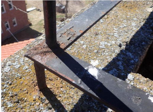
Kuva 36. Piipun teräskateissa korroosiovaurioita
