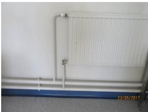
Kuva 5. Lämpöjohtot ja lämmityspatteri
