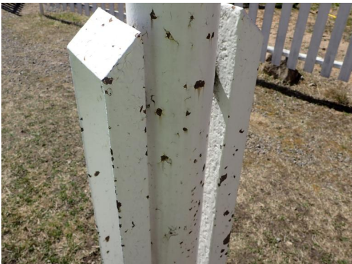
Kuva 5. Lipputangossa pinnoite- ja korroosioaurioita
