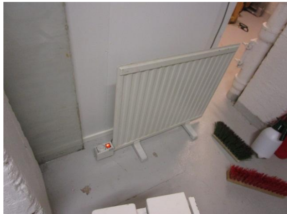
Kuva 41. Näkymää siirrettävästä lämmittimestä.
