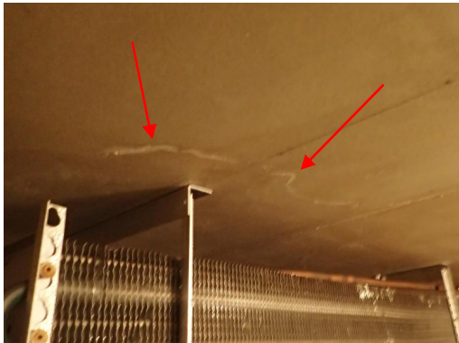
Kuva 44. Kylmäsäilytystilan katossa kosteusjälkiä
