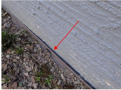
Kuva 7. Perusmuurin pinnalla patolevy, patolevyn yläreuna paikoin auki
