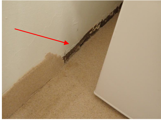
Kuva 47. Jääkaapin takana ylösnosto puutteellinen
