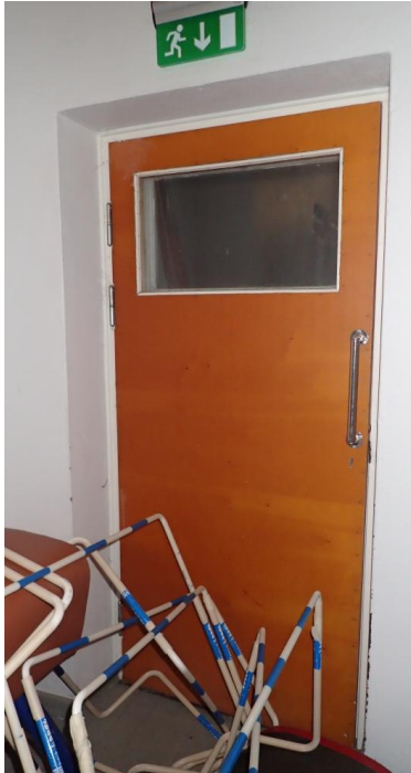
Kuva 22. Kaakkoispäädyn liikuntasalin hätäpoistumistien ovi. Oven edessä tavaraa.
