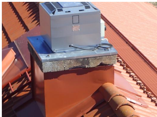
Kuva 35. Ilmanvaihtohormin betonissa lohkeama, liitos peltiin ei ole tiivis
