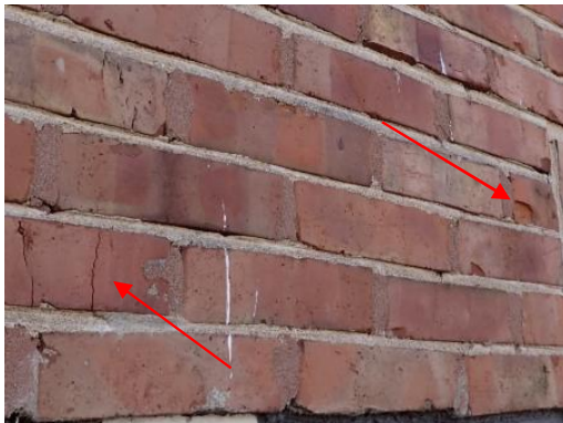
Kuva 12. Julkisivumuurauksessa yksittäisiä tiilien halkeiluja ja lohkeiluja
