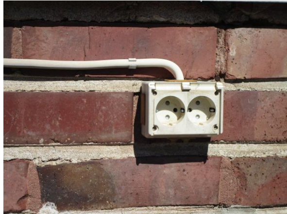
Kuva 35. Kalusteita on rikki ulkona.
