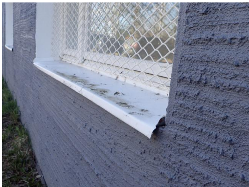
Kuva 16. Ikkunapeltien maalipinnoitteet kuluneet, peltien kaadot paikoin vähäiset
