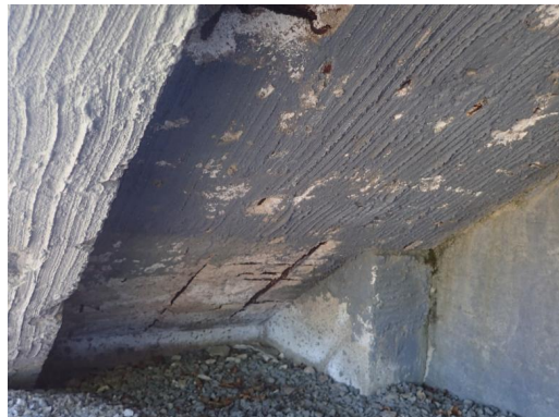
Kuva 27. Portaiden betonissa havaittavissa korroosioaurioita
