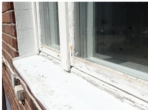
Kuva 15. Ikkunoiden maalipinnoitteet monin paikoin kuluneet
