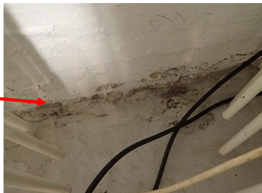
Kuva 9. Lattianrajassa havaittavissa kosteuden aiheuttamaa maalipintojen hilseilyä
