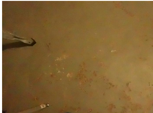
Kuva 45. Lattiassa kosteuden aiheuttamaa maalipinnoitteen irtoilua
