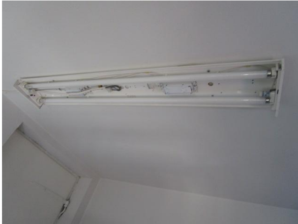
Kuva 38. Valaisimen suojakupu puuttui.
