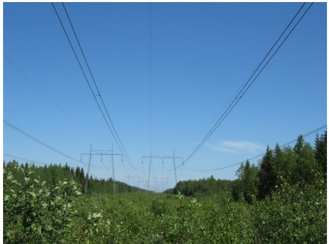
Kuva 19. Voimalinja Kivikaarrolla pohjoiskoilliseen.
