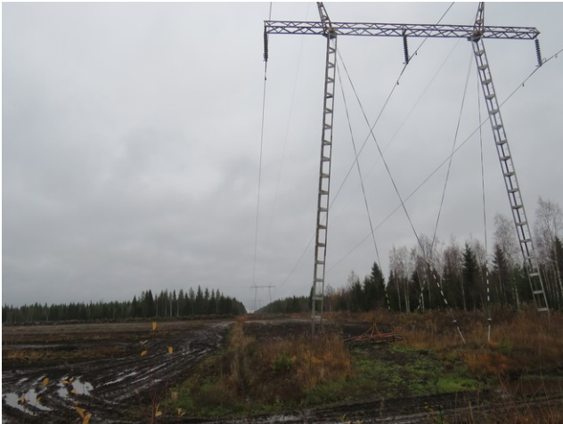
Kuva 9. 110 kV voimajohto suunnittelalueen lounaisosassa, kuvattu lounaaseen.
