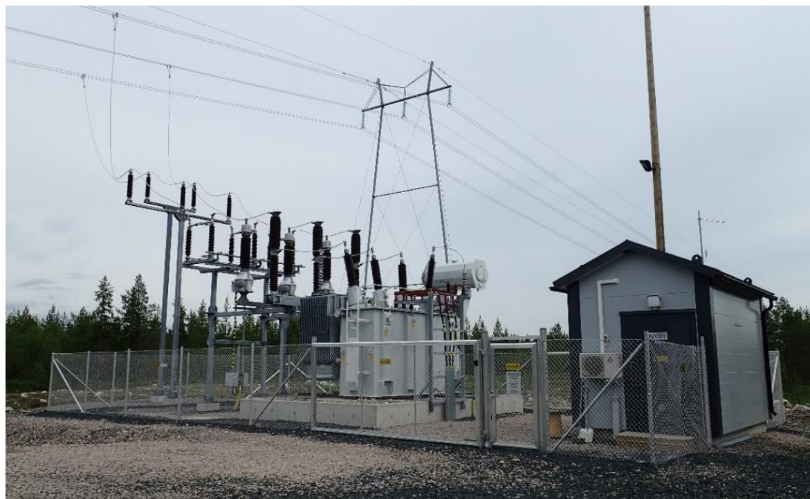
Kuva 8. Esimerkki tuulivoimapuiston sähköasemasta.
