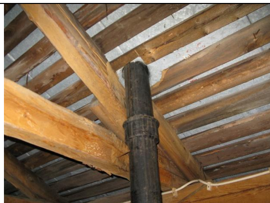
Kuva 21. Eristämätön viemärin tuuletusputki.
