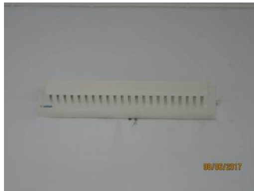
Kuva 69. Opetustilan vanha korvausilmaventtiili
