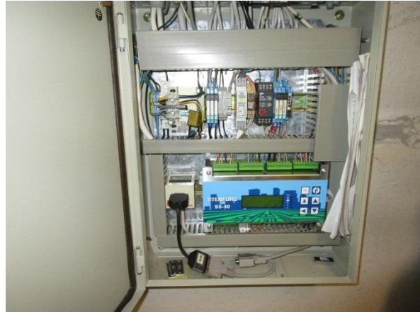
Kuva 118. Näkymää lämmönjakohuoneen VAK laitteesta.
