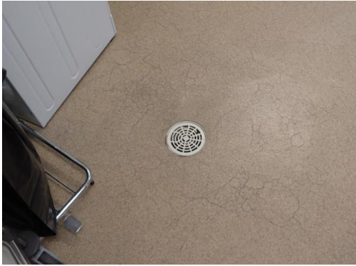
Kuva 64. Keittiön lattiapinnoitteessa paikoin halkeilua
