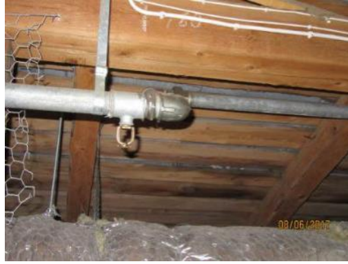
Kuva 75. Sprinkler suuttimista on poistettu sulakkeet
