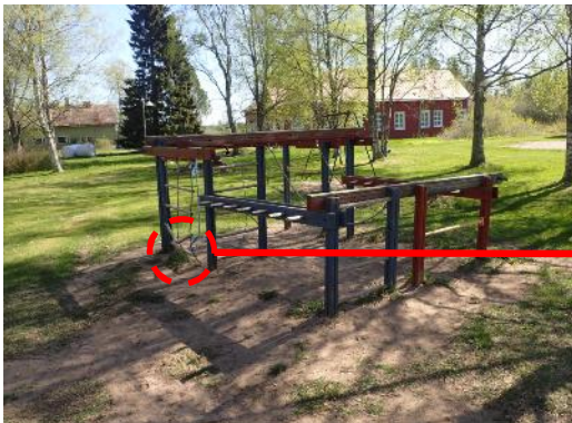
Kuva 5. Puinen rimpuiluteline paikoin huonokuntoinen
