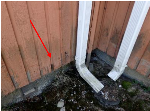
Kuva 22. Julkisivuverhouksen alaosissa paikoin lahovauriota
