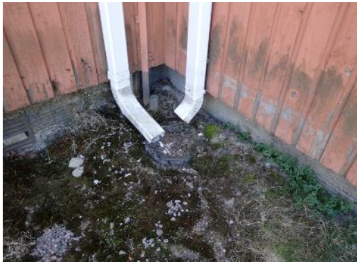
Kuva 9. Rännikaivon sihdin päällä roskaa
