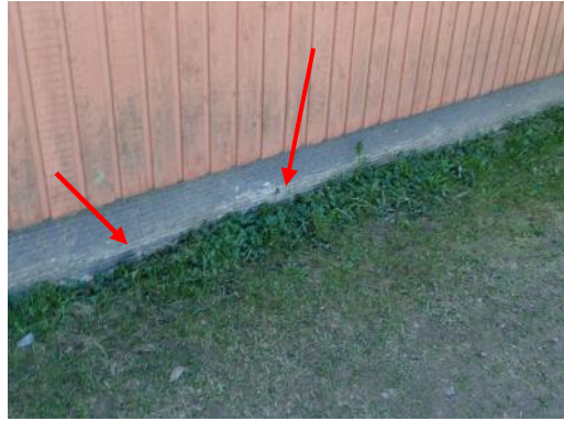
Kuva 27. Sokkeleiden maalipinnoitteet huonokuntoiset
