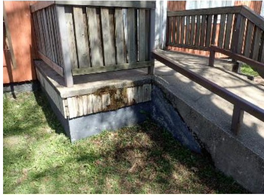
Kuva 44. Luiskan yläpäässä betonitason puuverhous huonokuntoinen
