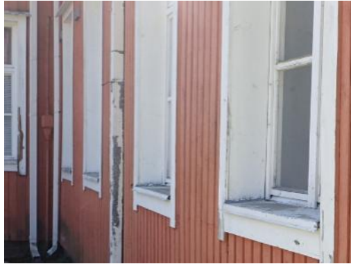
Kuva 31. Ikkunapelttien kaadoissa puutteita
