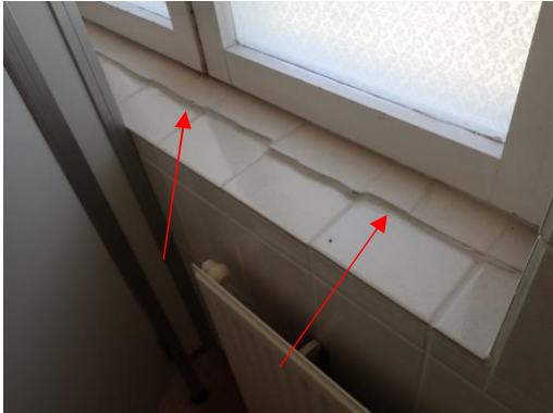
Kuva 70. Ikkunapenkin laatoitukset haljenneet
