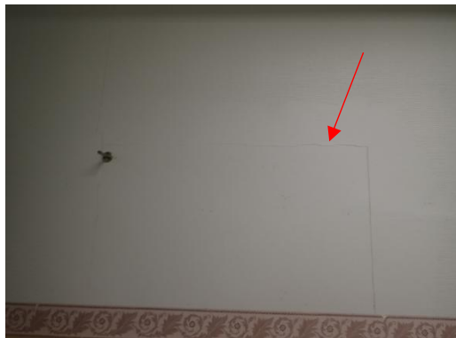
Kuva 60. Maalattua levy-pintaista seinää, paikoin halkeilua
