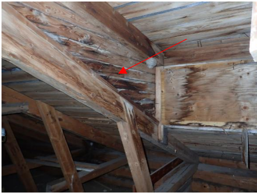
Kuva 53. Yläpohjassa havaittavissa kosteuden aiheuttamia jälkiä
