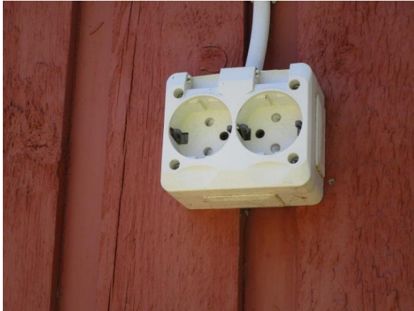
Kuva 99. Ulkoseinällä on rasian kansi rikki.
