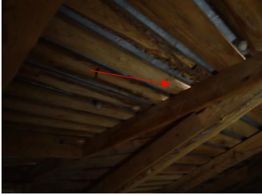
Kuva 51. Yläpohjasta havaittavissa vesikatteen aukkoja
