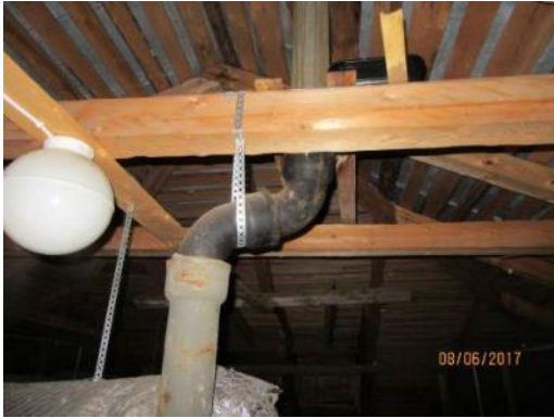
Kuva 88. Vanha valurautainen tuuletusviemäri ullakolla
