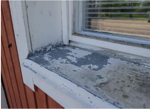
Kuva 30. Ikkunapelttien maalipinnoite monin paikoin hilseillyt
