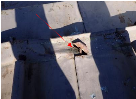
Kuva 49. Vesikatteessa reikä, jonka kautta vesien pääsy yläpohjaan on mahdollista
