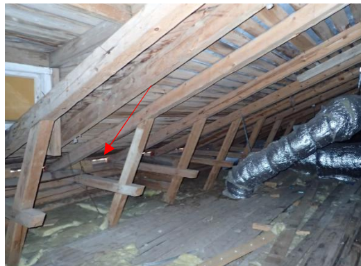
Kuva 54. Yläpohjan tuuletusraot ovat paikoin niukat
