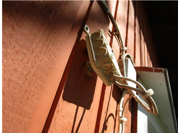
Kuva 100. Ulkoseinällä on rasioita irti.
