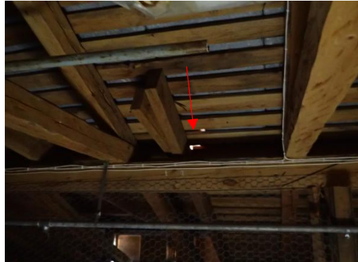
Kuva 52. Yläpohjasta havaittavissa vesikatteen aukkoja
