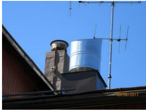
Kuva 64. Vanha huippuimuri ja IV-koneen ulospuhallushajoittaja
