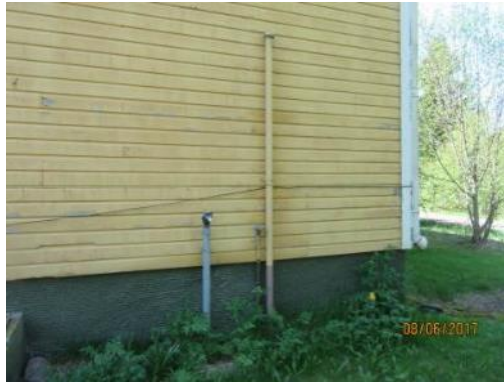
Kuva 79. Öljysäiliön täyttö- ja ilmaputki sekä ylitäytön estin
