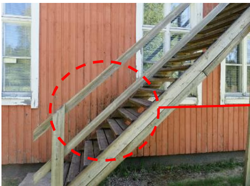
Kuva 24. Rakennuksen lännenpuoleisella seinustalla huonokuntoista julkisivuverhousta
