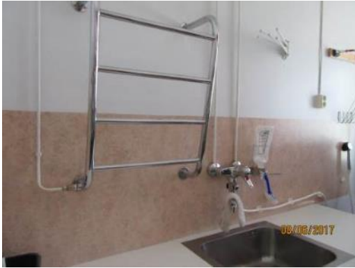
Kuva 84. Vesijohdot ovat kupariputkia
