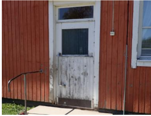
Kuva 34. Ovien kunto paikoin huono
