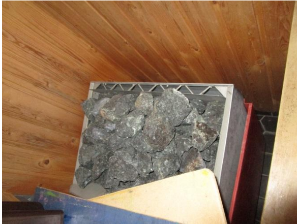
Kuva 105. Käytöstä poistettu kiuas
