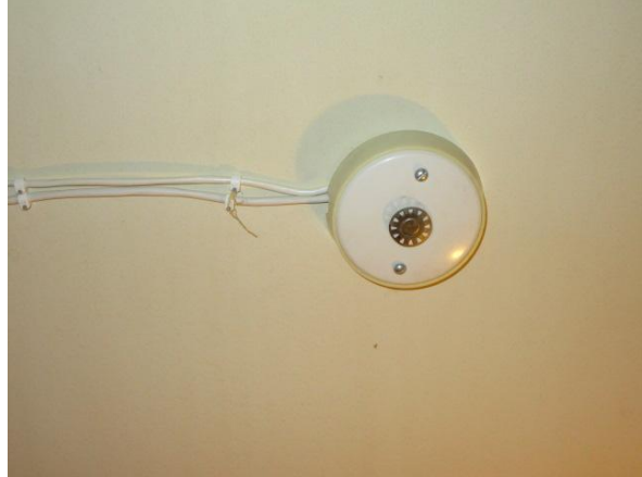
Kuva 116. Näkymää paloilmamaisimista kellarissa.
