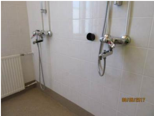
Kuva 86. Vesikalusteet ovat kunnossa
