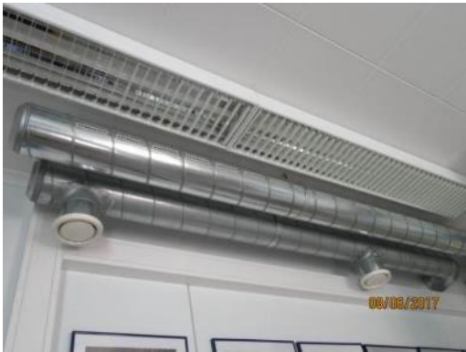
Kuva 67. Poistoilmaventtiilit ja tuloilman suutinkanava
