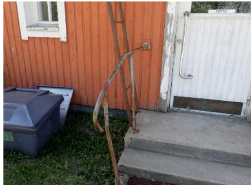
Kuva 42. Katoksen kaiteiden maalipinnoitteet ovat kuluneet
