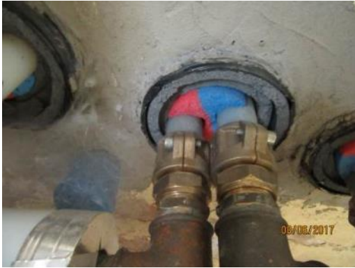
Kuva 80. Lämpöjohtojen lähtö naapurirakennuksesta koulurakennukseen
