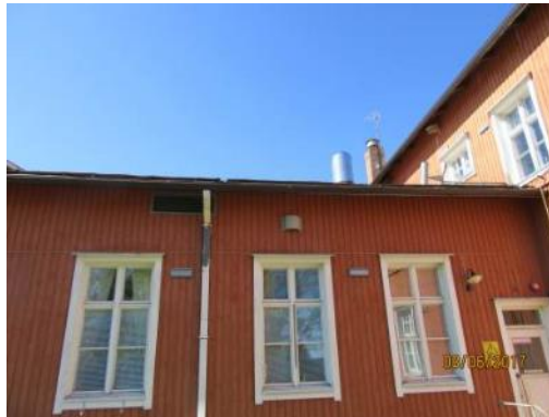
Kuva 70. Korvausilmaventtiilien ulkosäleiköt ikkunoitten välissä
