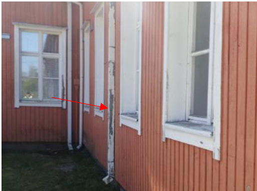
Kuva 13. Syöksyputken maalipinta hilseillyt
