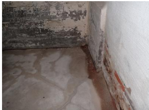
Kuva 17. Kellaritilan lattioissa kosteuden aiheuttamia jälkiä
