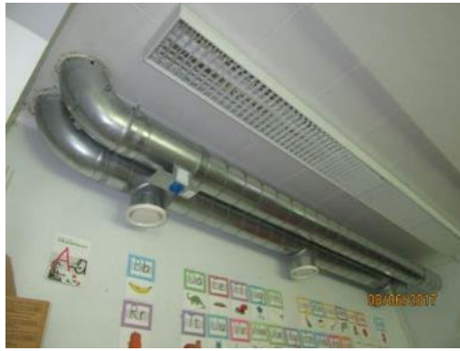
Kuva 68. Poistoilmaventtiilit ja tuloilman suutinkanava
