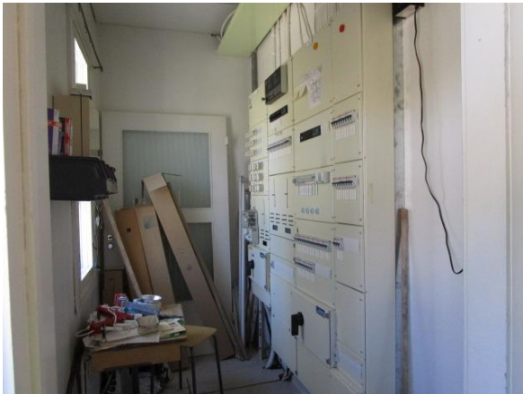
Kuva 93. Pääkeskus näkymää (ylimääräistä tavaraa).
