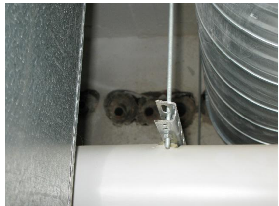
Kuva 26. Tulppaamattomia ja käytöstä poistettuja putkia varaston K028 maanvastaisessa seinässä.
