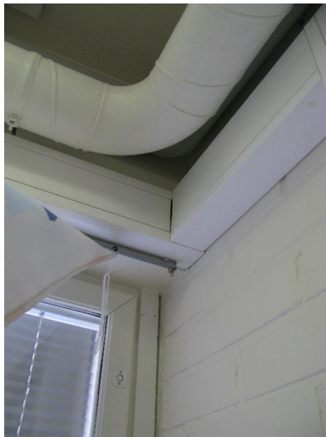
Kuva 25. Vastaanottohuoneen K003 ikkunan ja väli-/ulkoseinän liittymässä on rako.
