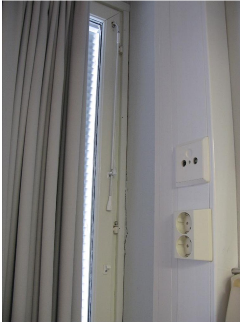
Kuva 17. Karmi-/väliseinä-/ulkoseinäliittymässä on rako.
