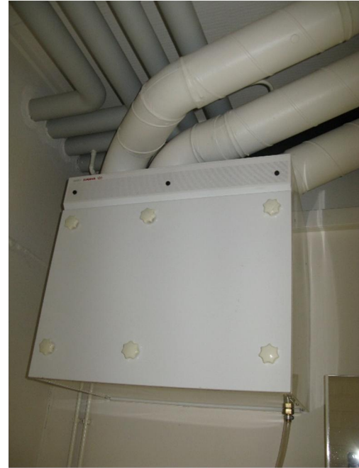
Kuva 7. Terveystieteiden vastanottotilojen ilmanvaihtokone.
