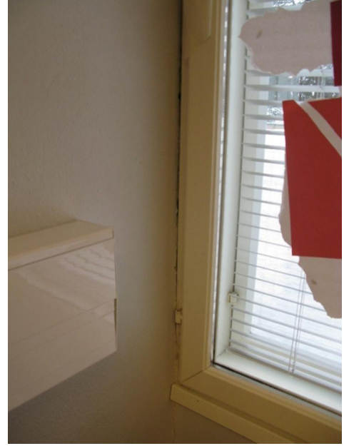
Kuva 11. Opetustilan 114 seinien ja ikkunan liittymässä on vuotoilmareitti.
