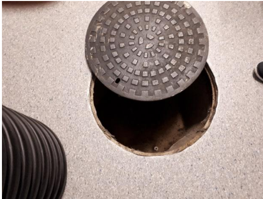
Kuva 8. Välinevaraston 112 pohjavesiviemärin tarkastuskaivo.
