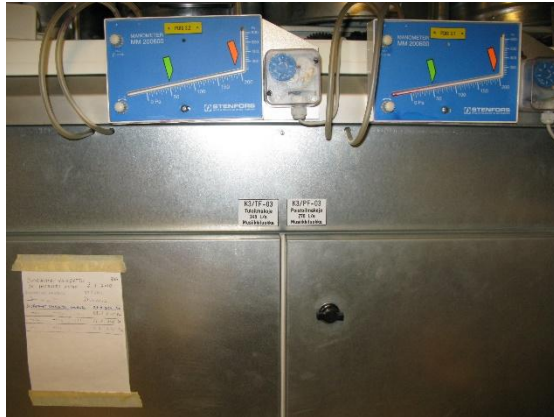
Kuva 27. Kellarikerroksen IV-kone K3.
