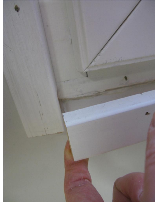
Kuva 18. Opetustila 142. Karmin ja ulkoseinän liittymä on tiivis.
