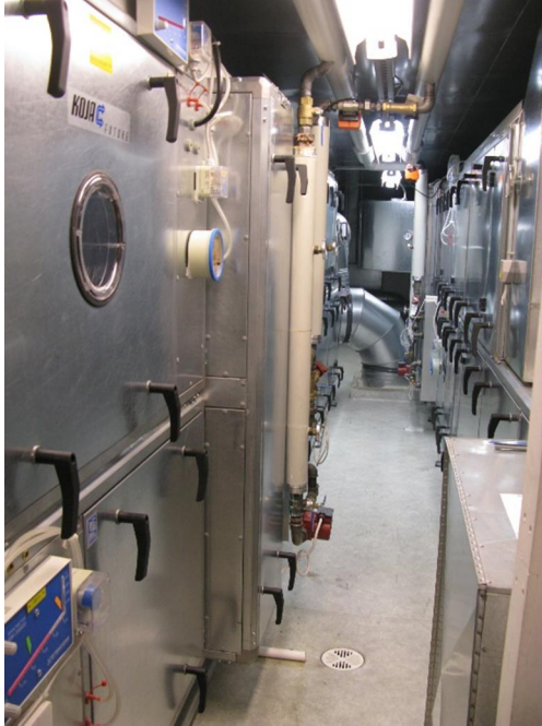
Kuva 6. B-osan ilmanvaihtokonehuone 203. Koneet K1 ja K2.
