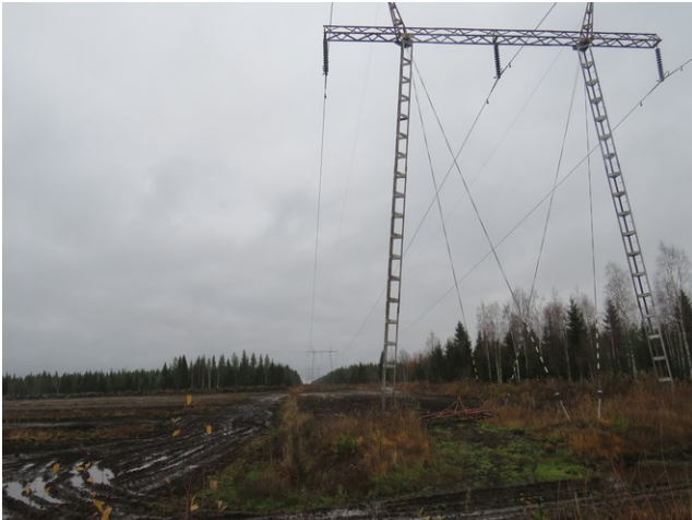
Kuva 9. 110 kV voimajohto suunnittelualueen lounaisosassa, kuvattu lounaaseen.
